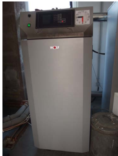
im Holzvergaserkessel können Presslinge und Rest-Holzabschnitte verfeuert werden
